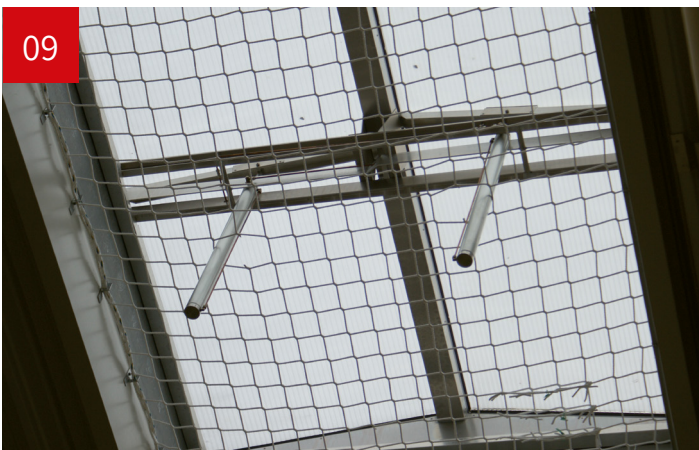
09 Lichtkuppel öffnen zur Kontrolle ob Zylinder frei beweglich ist
